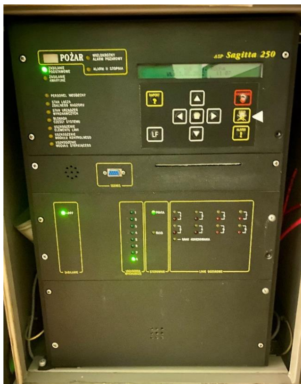
Zdjęcie Centrala monitoringu przeciwpożarowego zlokalizowana w analizowanym obiekcie
