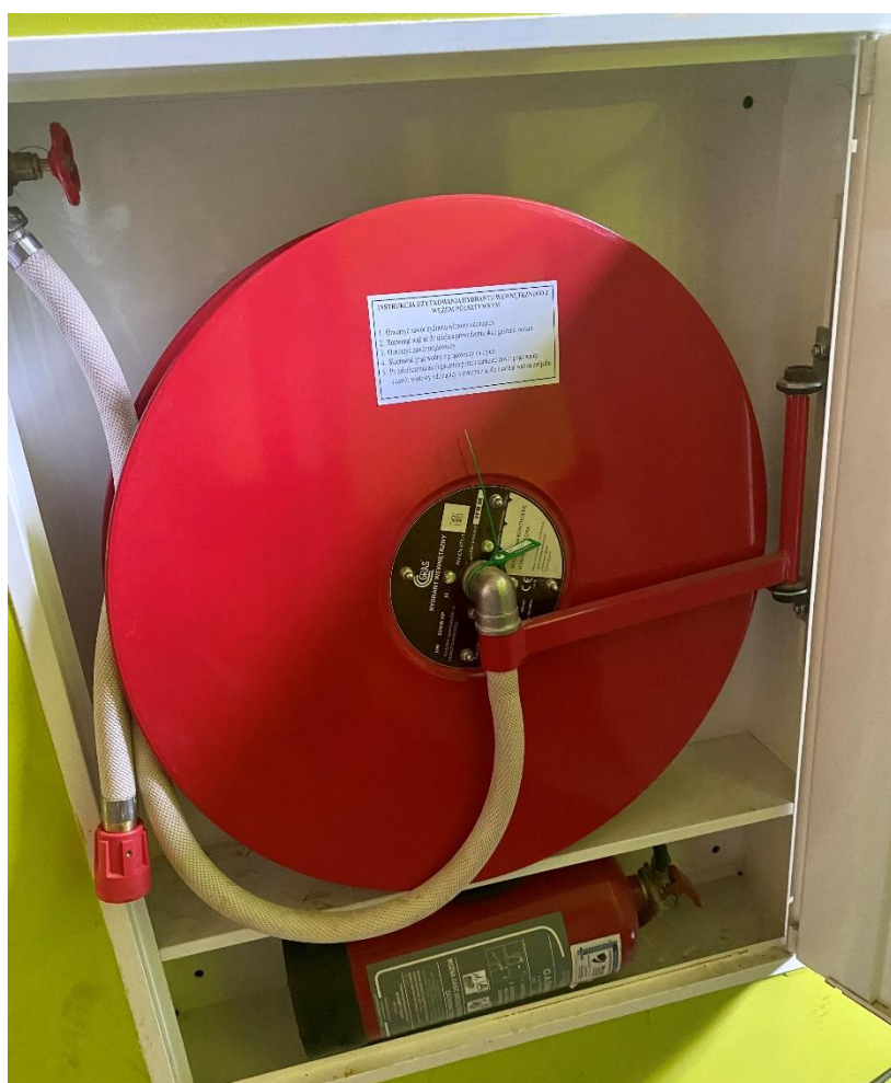
Zdjęcie Hydrant wewnętrzny zlokalizowana w analizowanym obiekcie
