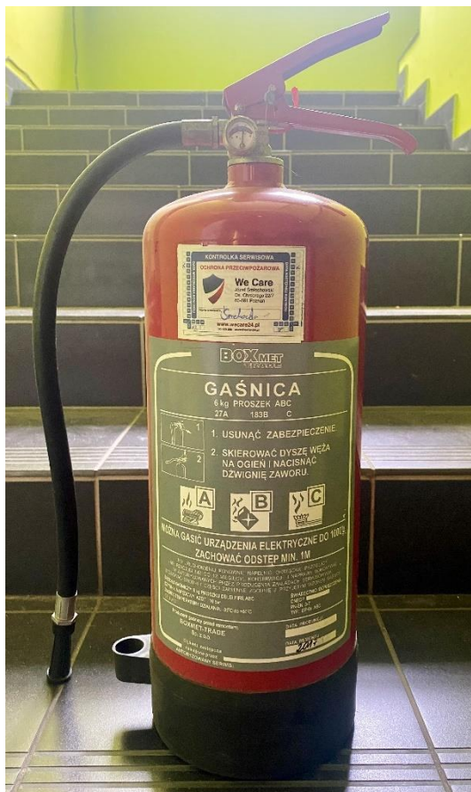
Zdjęcie Gaśnica proszkowa zlokalizowana w analizowanym obiekcie
