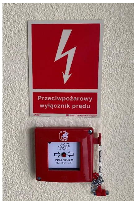
Zdjęcie Przeciwożarowy wyłącznik prądu zlokalizowany w analizowanym obiekcie
