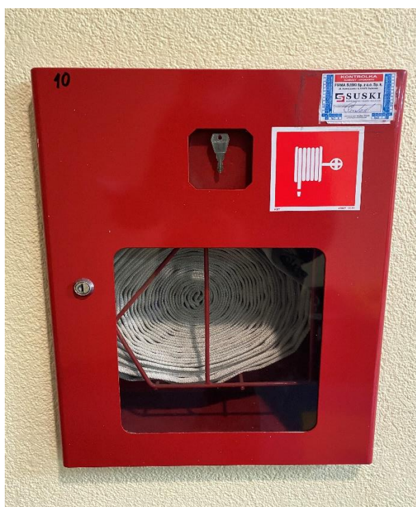
Zdjęcie Hydrant wewnętrzny zlokalizowany w analizowanym obiekcie
